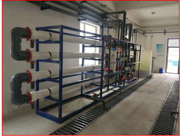
渗滤液处理装置
